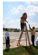
民間企業がパブリックサービスを提供(写真は標識等の設置の様子)
